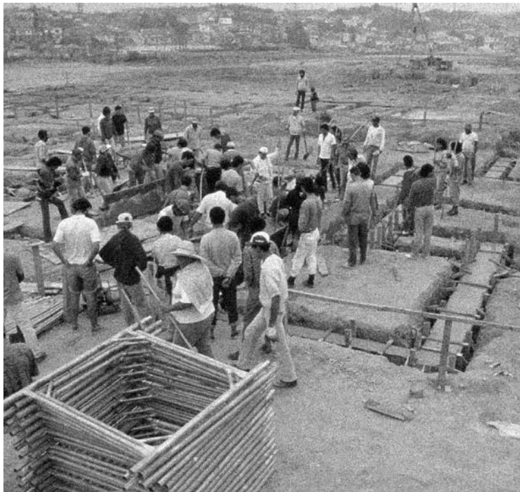
ao lado Mutirão executando as vigas baldrame de um dos edifícios do COPROMO
