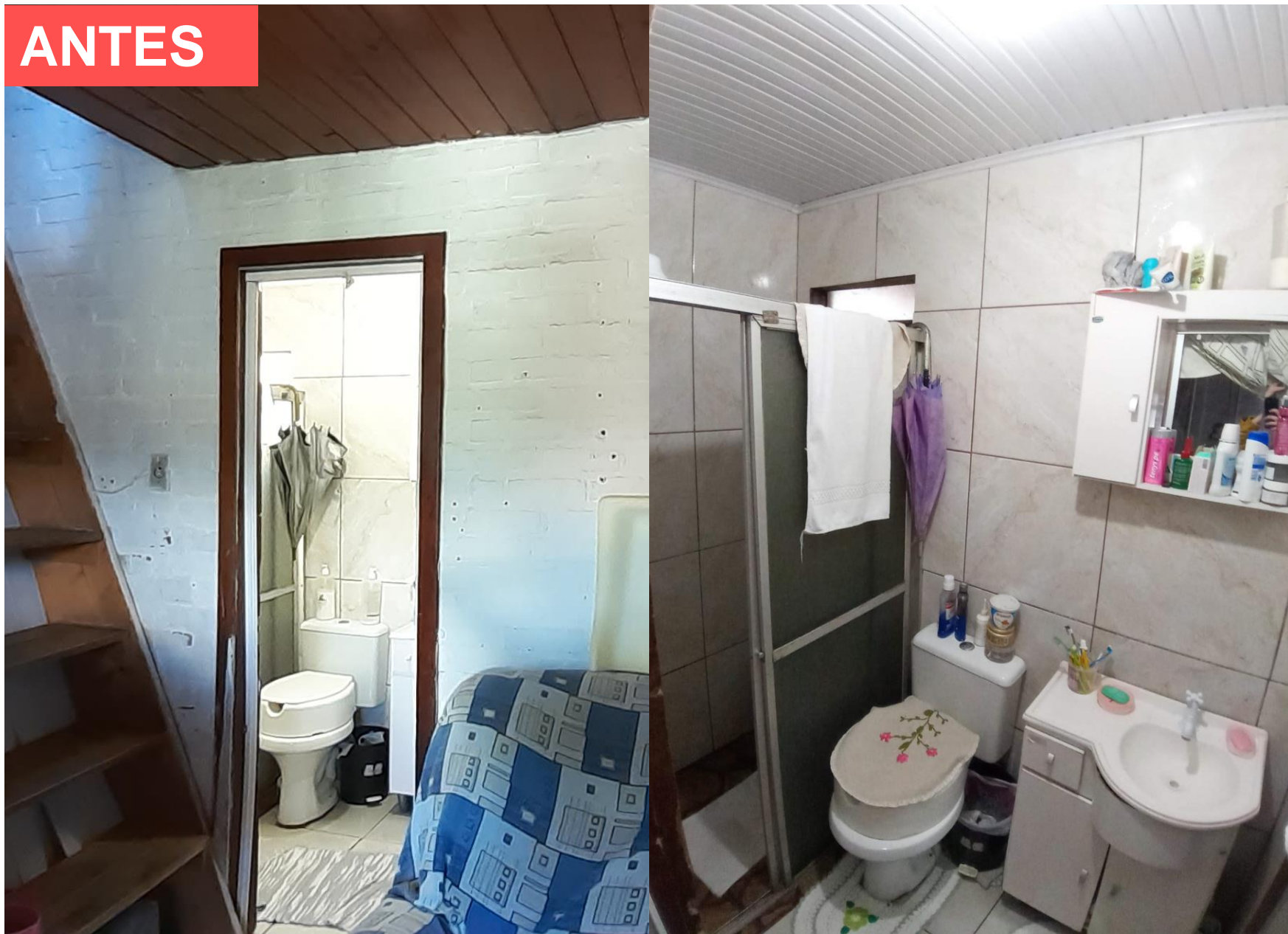
Banheiro existente. Bairro Reolon em Caxias do Sul. Foto: IAB/RS
