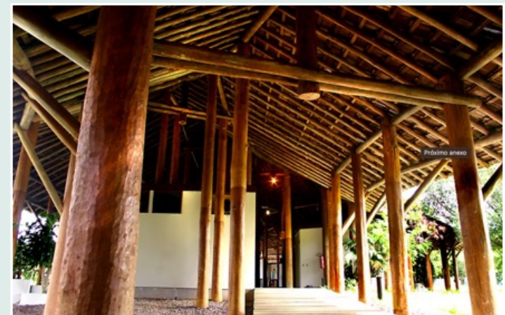
Imágenes del Centro de Protección Ambiental de Balbina (AM), ahora en ruinas.
